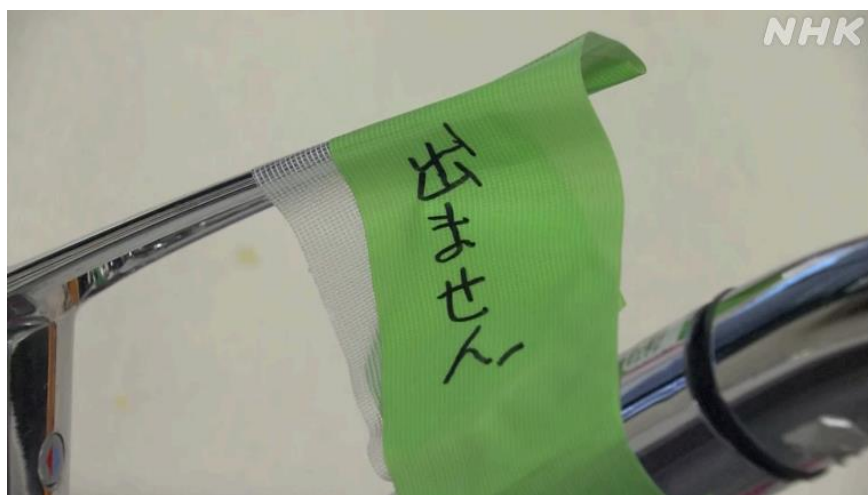
能登半島地震で断水となった水道
